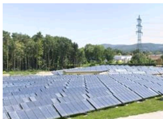
Blick auf das Kollektorfeld Wasserwerk Andritz
